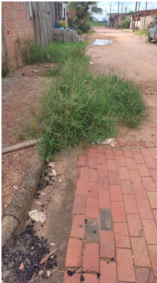
Figura 1 – Necessidade de limpeza e roçagem.
