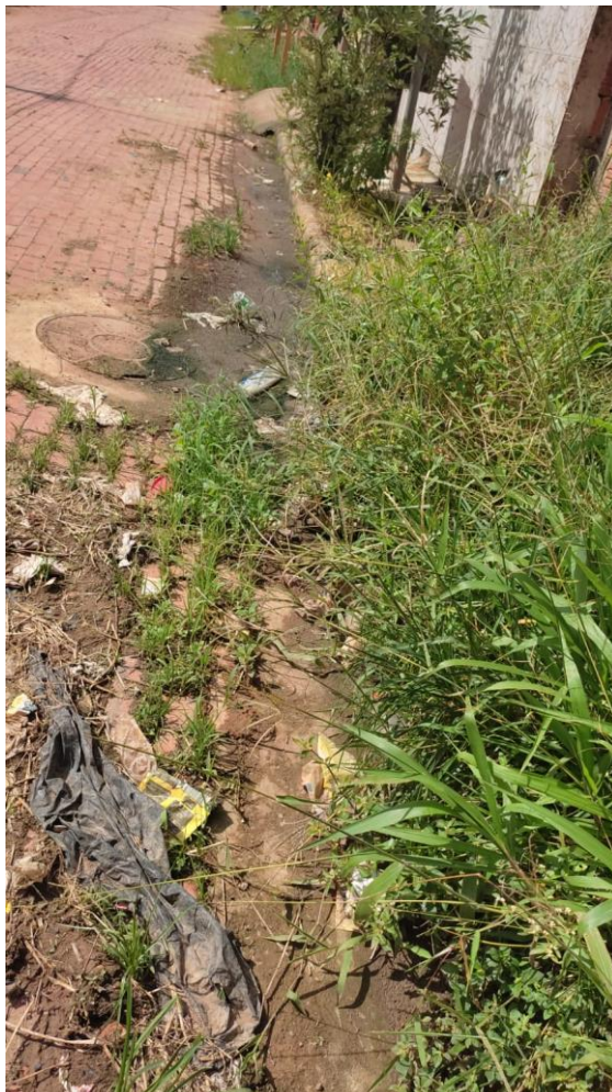
Figura 1 – Pavimentação com buracos e esgoto cheio(entupido).
