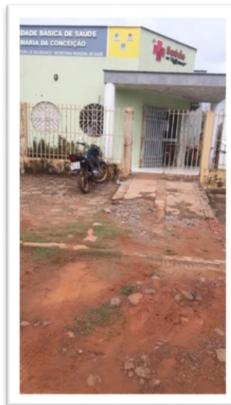
Figura 2 – Rampa sem condições de uso.
