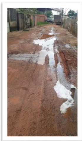
Figura 1 – Rua sem pavimentação.
