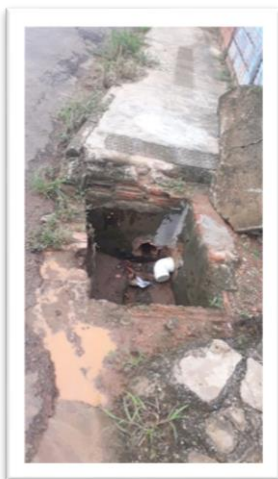
Figura 1 – Esgoto sem tampa.
