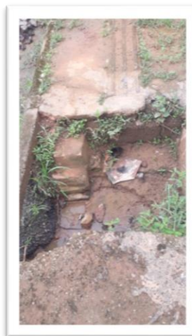
Figura 2 – Esgoto sem tampa.
