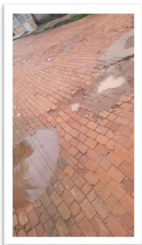
Figura 1 – Buracos na via pública.
