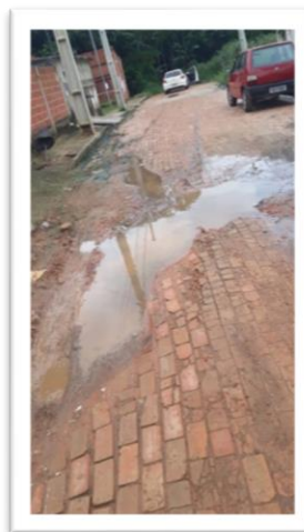
Figura 2 – Buracos na via pública.
