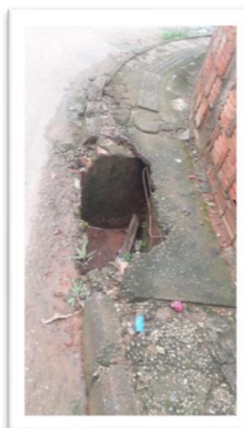
Figura 2 – Tapa de bueiro.
