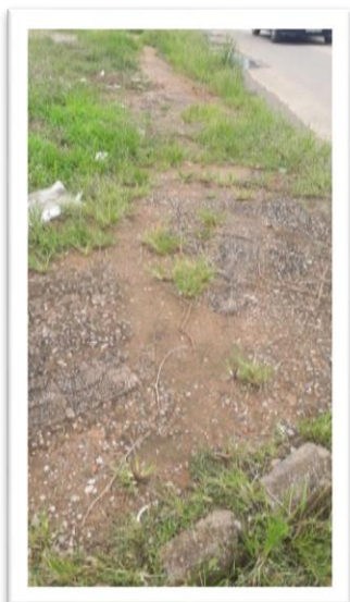
Figura 1 – Mato cobrindo o calçamento.
