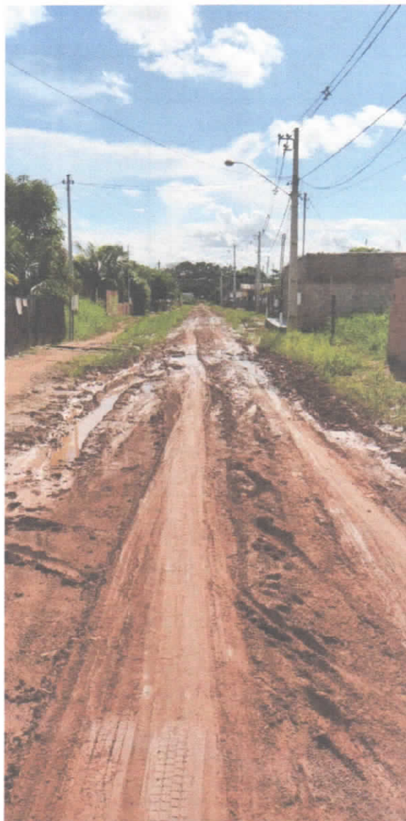
Figura 1 – Rua sem sistema de esgoto e pavimentação.
