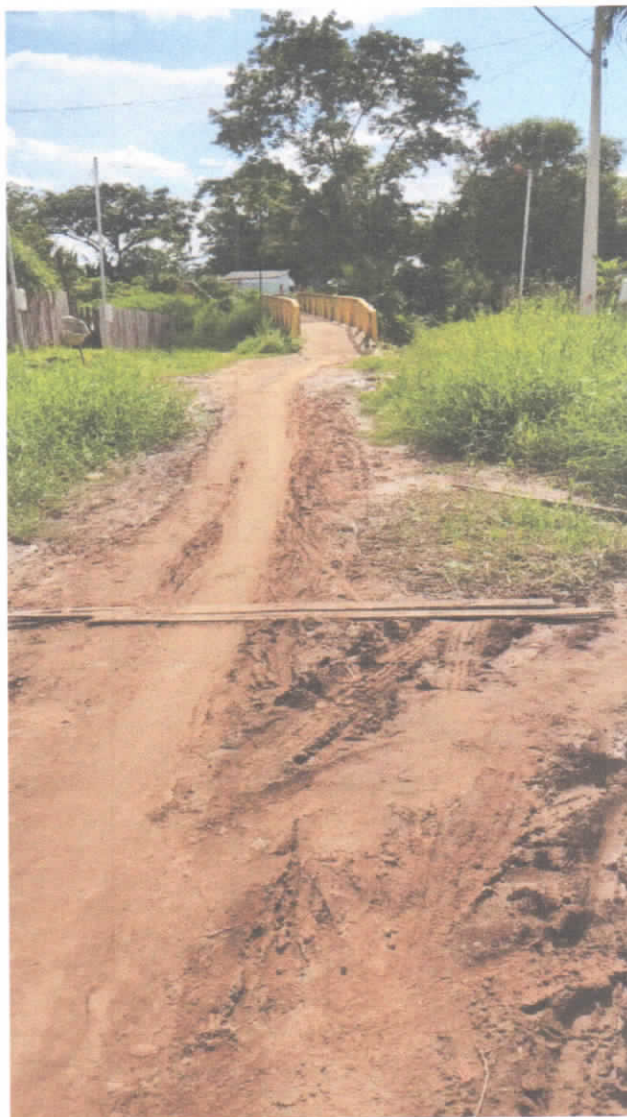
Figura 2 – Com as chuvas a rua fica praticamente intráfegável.
