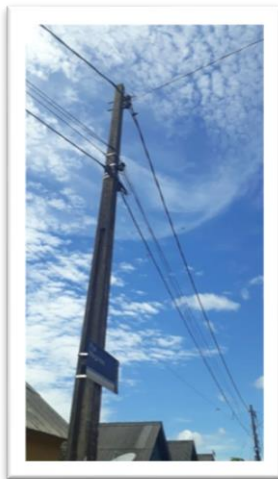
Figura 1 – Iluminação de via pública.
