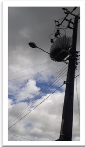
Figura 1 – Poste de energia elétrica sem iluminação pública.
