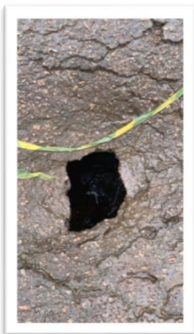
Figura 1 – Buraco se abrindo na rua principal do bairro.
