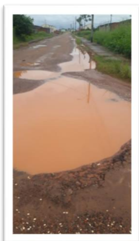
Figura 1 – Buraco tomando a rua.
