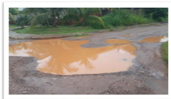
Figura 2 – Buraco tomando a rua.
