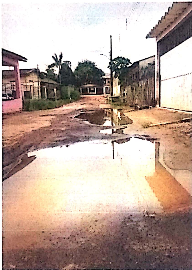
Figura 3 – Buraco que acumula água da chuva.
