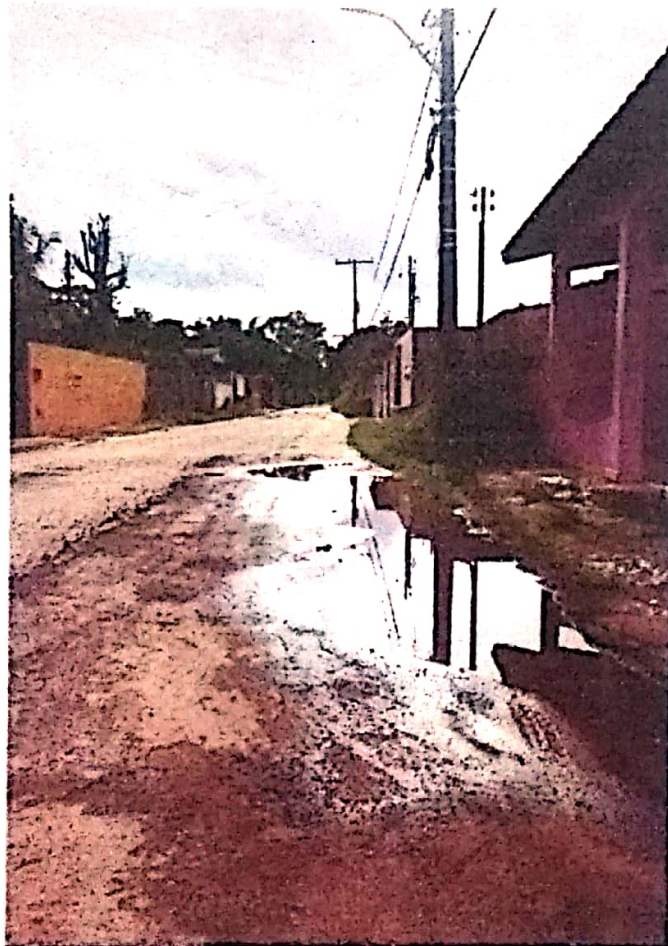
Figura 6 – Parte pavimentada da rua com buraco e represamento de água da chuva.
