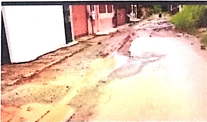
Figura 8 – Parte pavimentada da rua com buracos.
