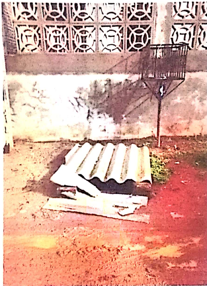
Figura 5 – Bueiro coberto por parte de uma telha.
