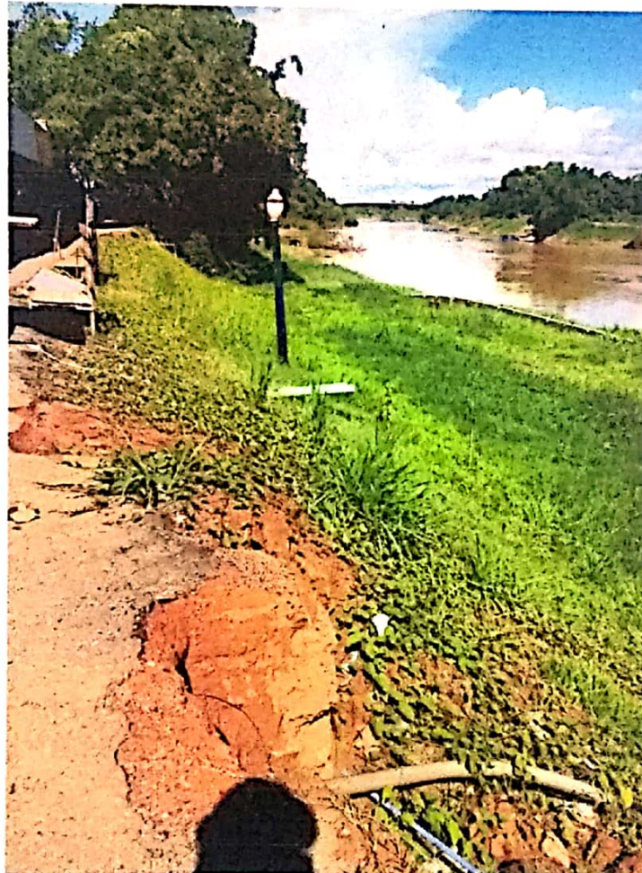
Figura 2 – Desbarrancamento sem nenhuma contenção ou proteção para garantir a segurança dos lojistas e pedestres.
