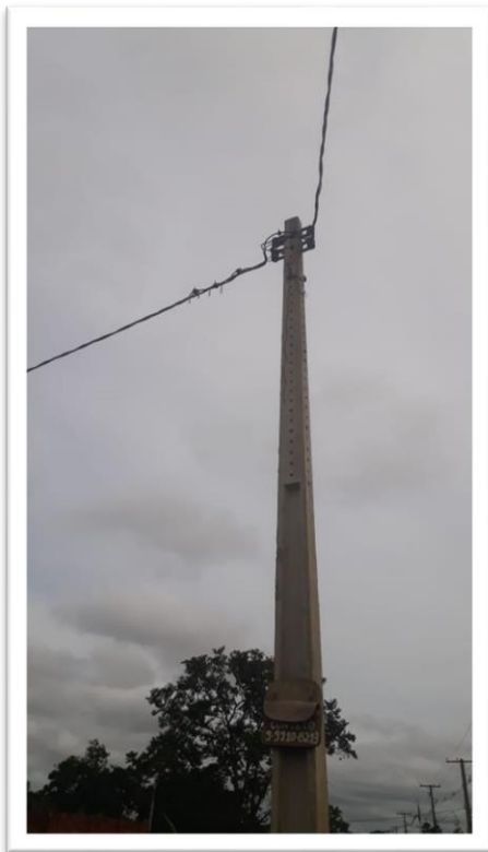
Figura 1 – Iluminação de via pública.
