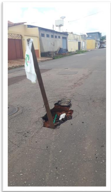
Figura 1 – Cratera se abrindo em via pública.
