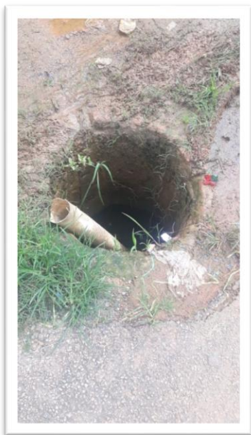
Figura 1 – Tapa de bueiro em via pública.
