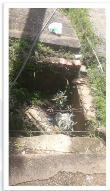
Figura 2 – Tapa de bueiro em via pública.
