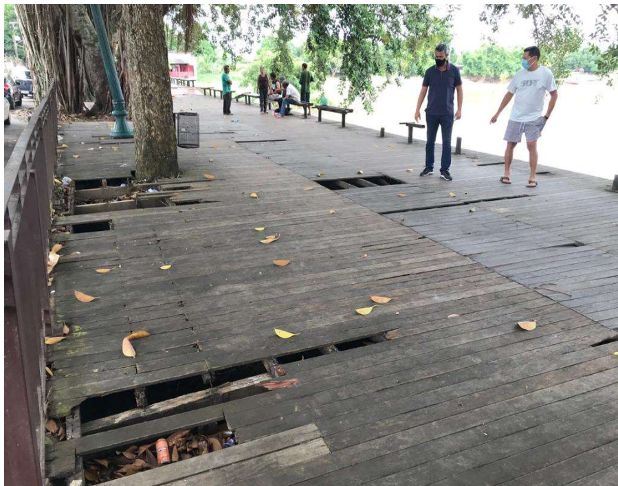
Figura 4 – Calçada apresentando vários buracos em sua estrutura.
