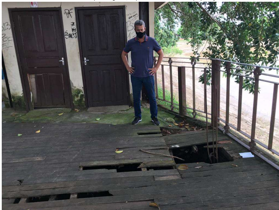
Figura 3 – Local do Calçadão onde apresenta a estrutura deteriorada, contendo buraco de grande extensão e barra de ferro pontiaguda, representando risco à população.
