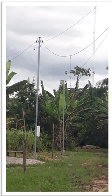
Figura 1 –Iluminação de Via Pública.
