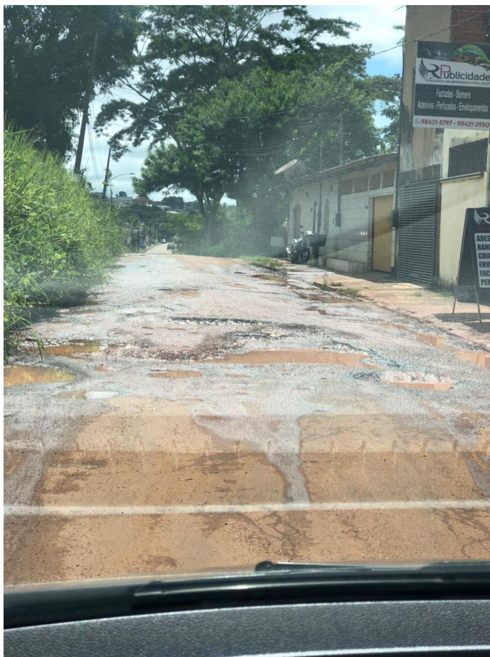
Figura 1 – Avenida com vários problemas Viários, asfalto com bastante buracos.
