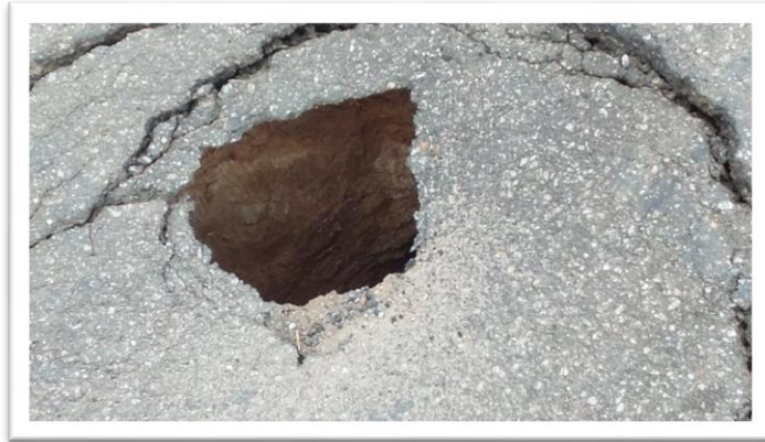
Figura 1- Cratera se abrindo em Via Pública.
