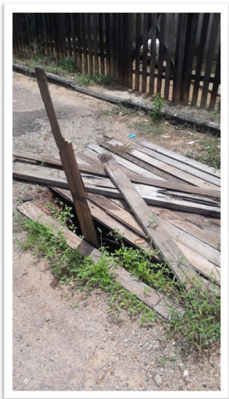
Figura 1-Tampa de Bueiro em Via Pública.
