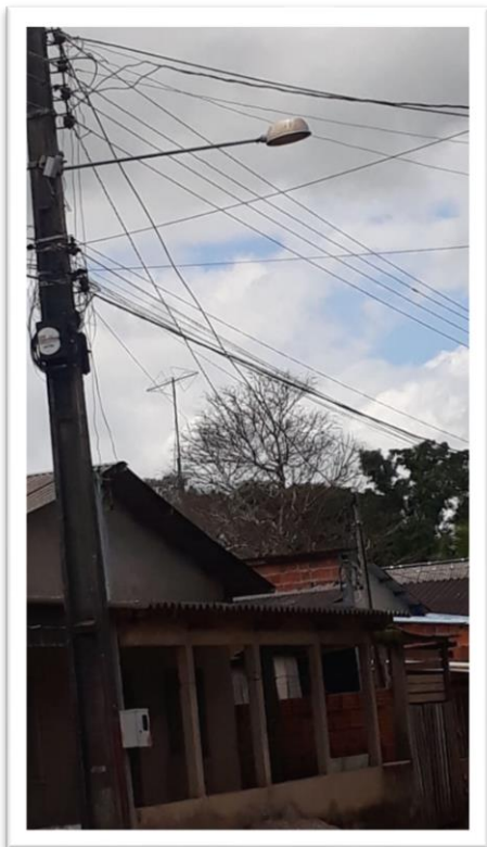
Figura 1-Iluminação de Via Pública.
