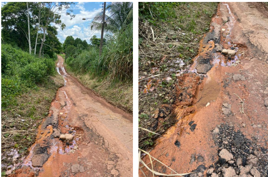
Figura 1 – Rua com vários problemas Viários, asfalto com bastante buracos.
