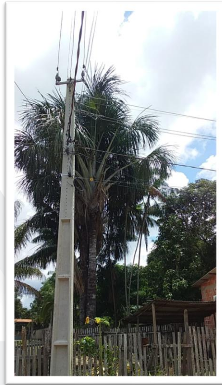
Figura 2-Iluminação de Via Pública.
