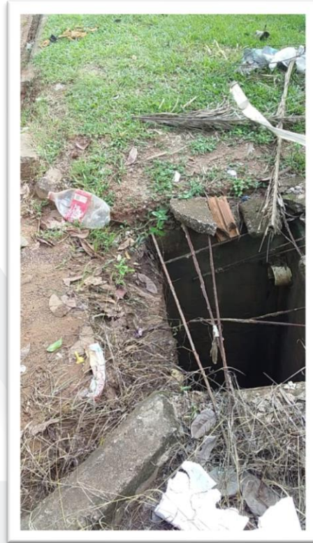
Figura 2-Tampa de Bueiro em Via Pública.
