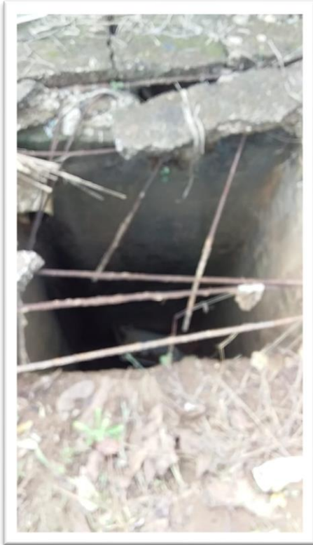
Figura 1-Tampa de Bueiro em Via Pública.
