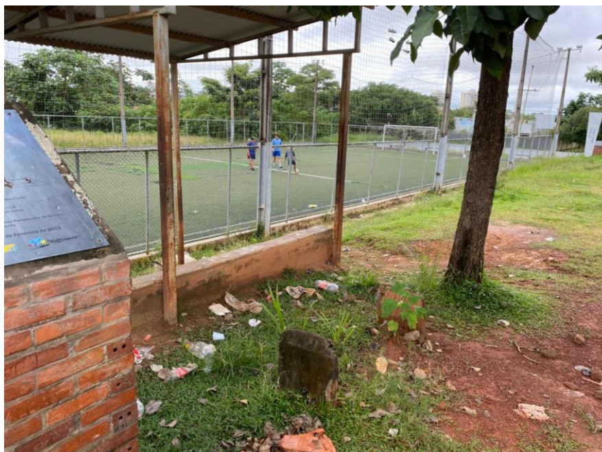
Figura 1 – Quadra precisando de manutenção e limpeza..
