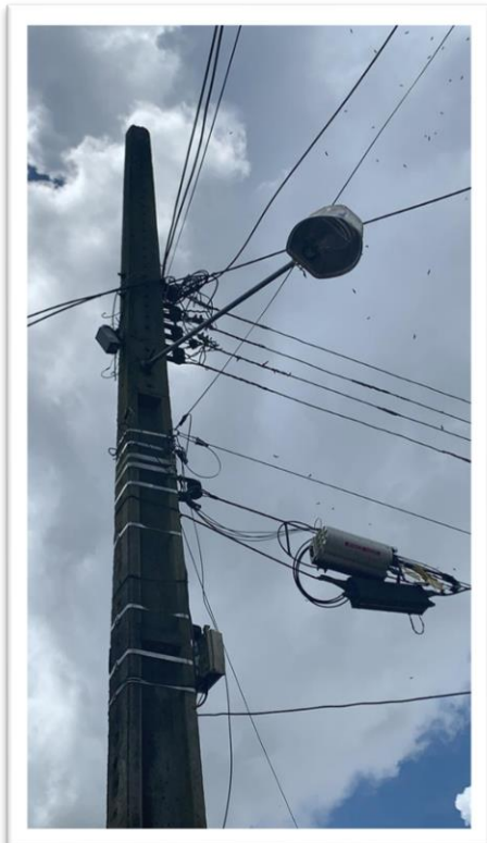
Figura 1- Iluminação de via pública.
