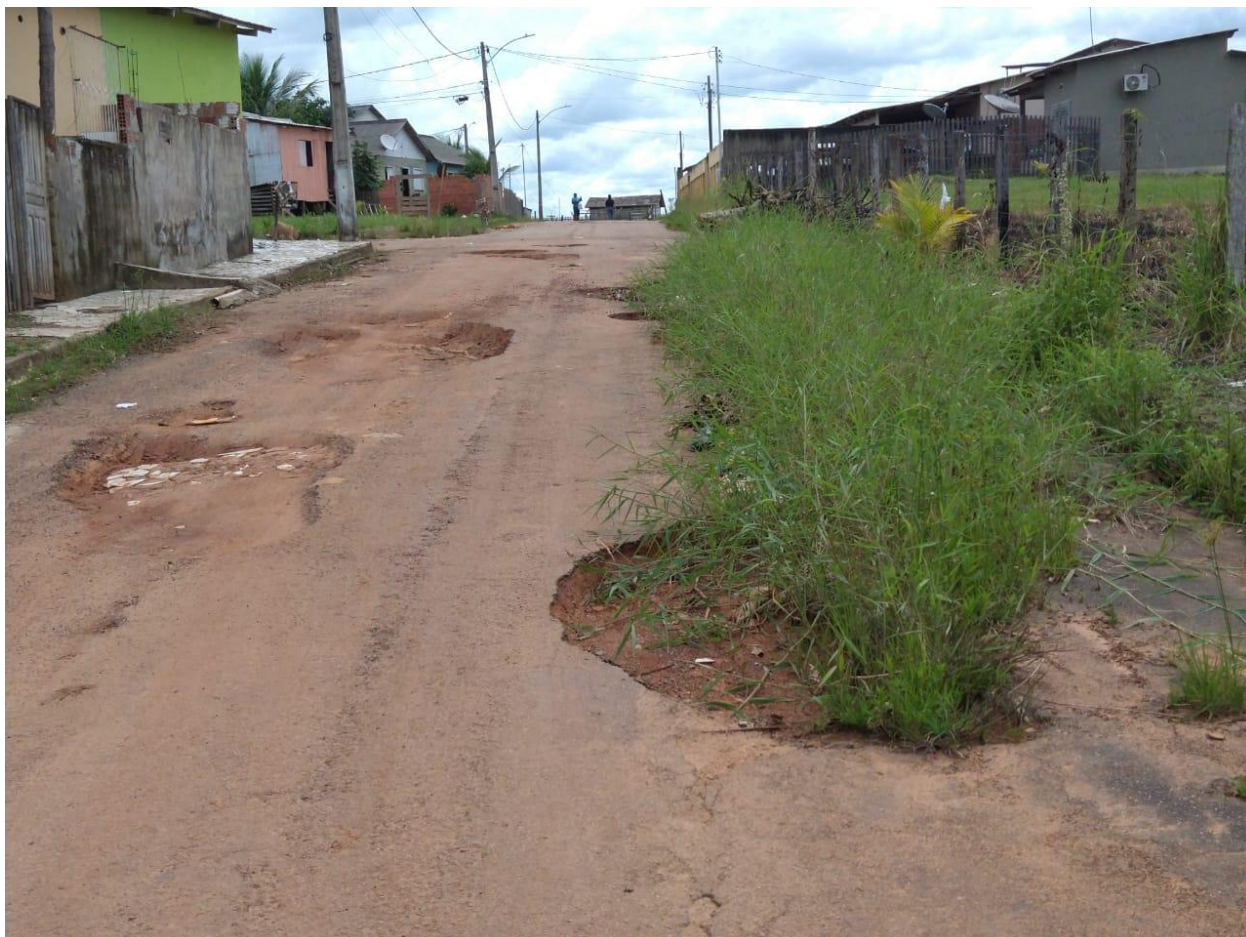
Figura 1 – Rua que necessita de reparos.
