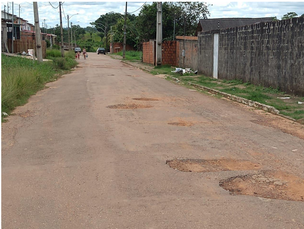
Figura 1 – Rua que necessita de reparos.
