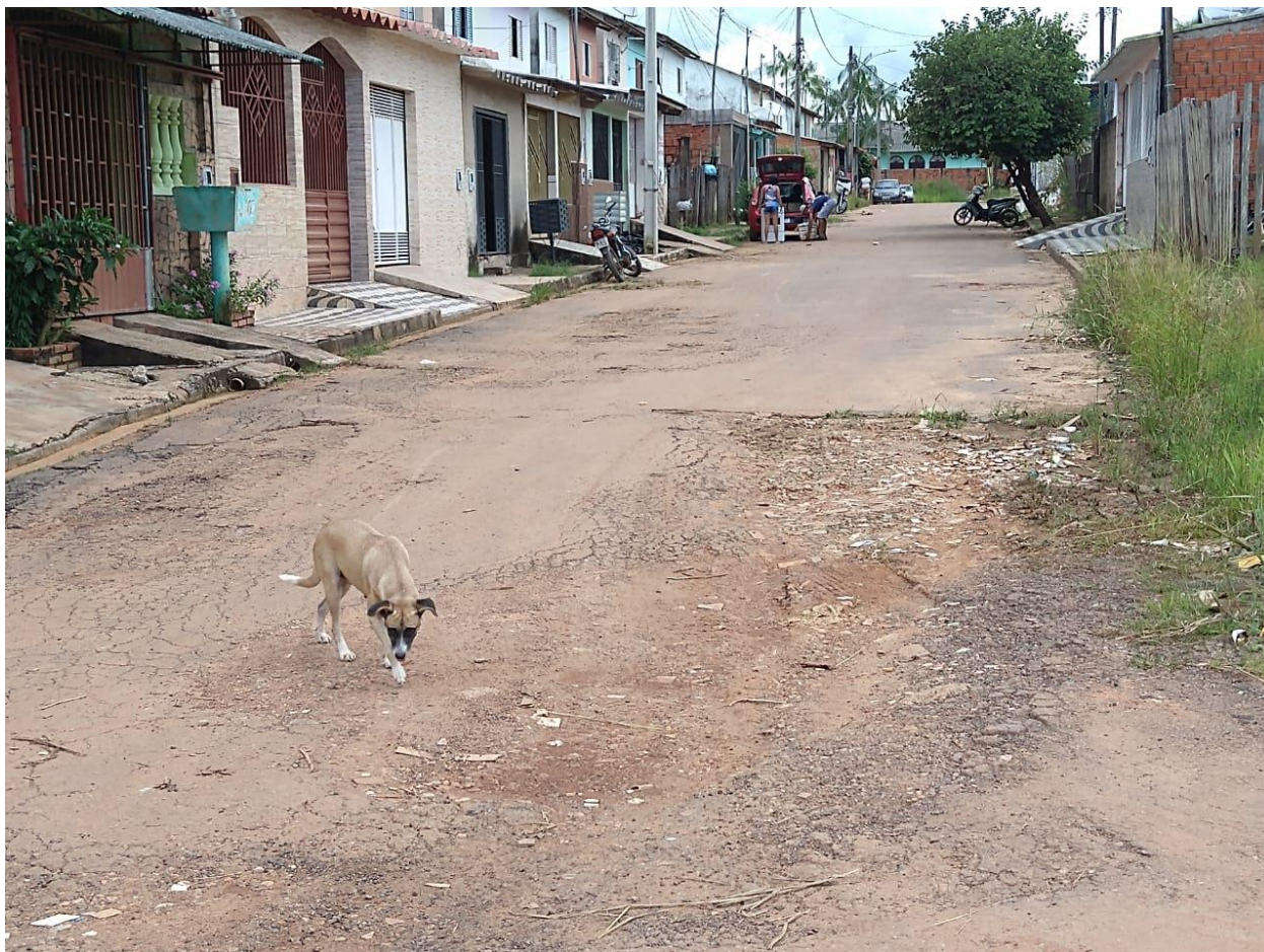
Figura 1 – Rua que necessita de reparos.
