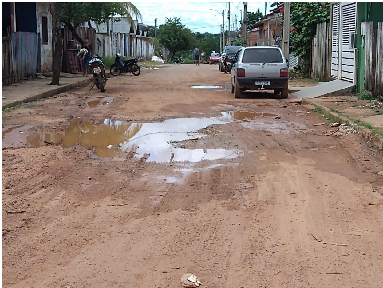
Figura 2 – Rua Araguari – reparos na pavimentação.
