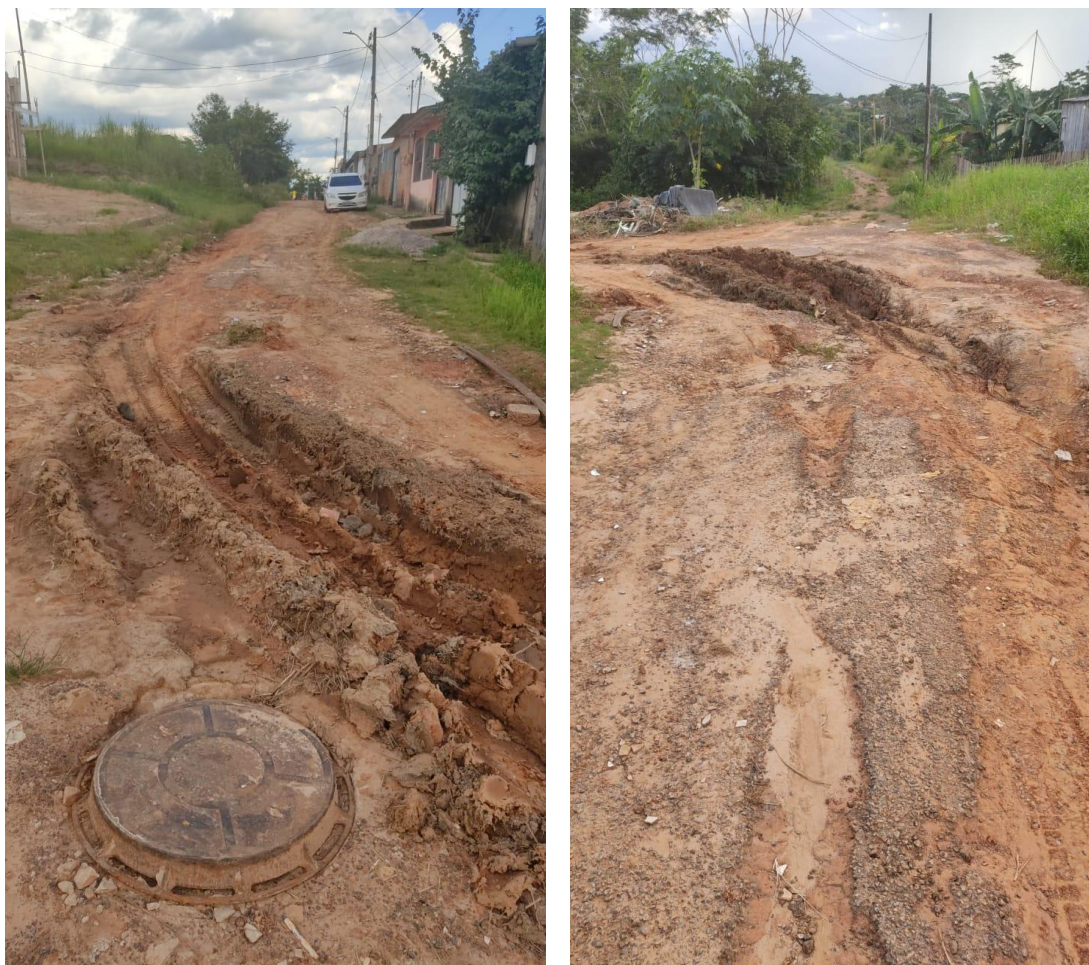
Figura 1 – Rua sem asfalto e drenagem adequada.
