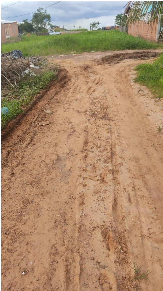
Figura 1 – Rua sem asfalto e drenagem adequada.
