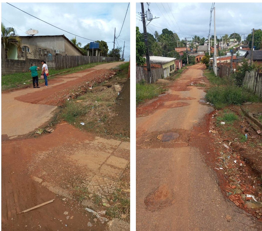
Figura 1 – Rua com bastante problema no asfalto e limpeza urbana.
