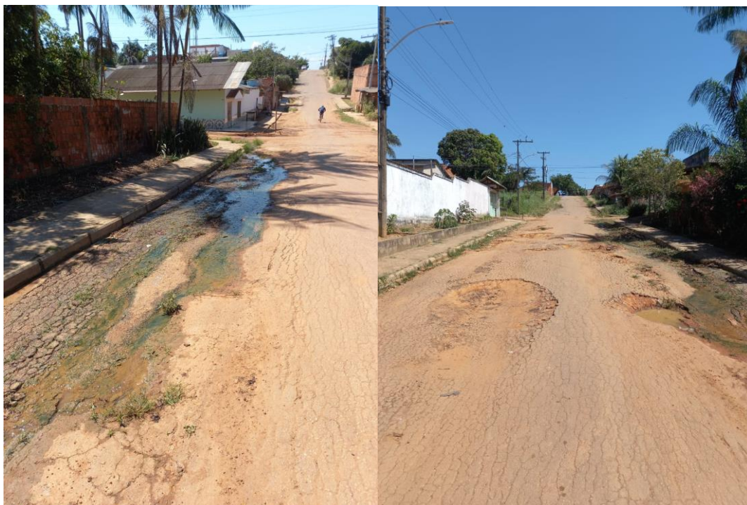
Figura 1 – Pavimentação com buracos e esgoto cheio(entupido).
