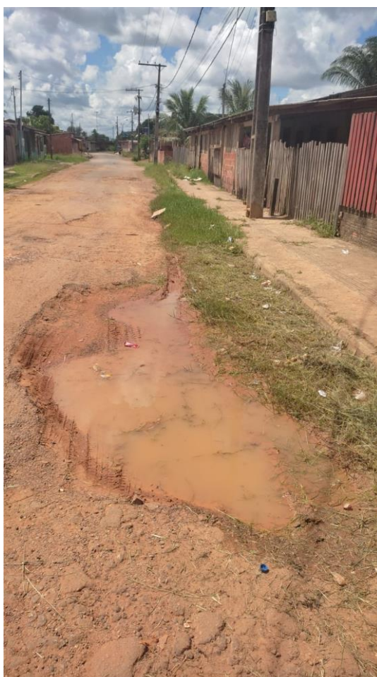
Figura 1 – Necessidade de limpeza e roçagem.
