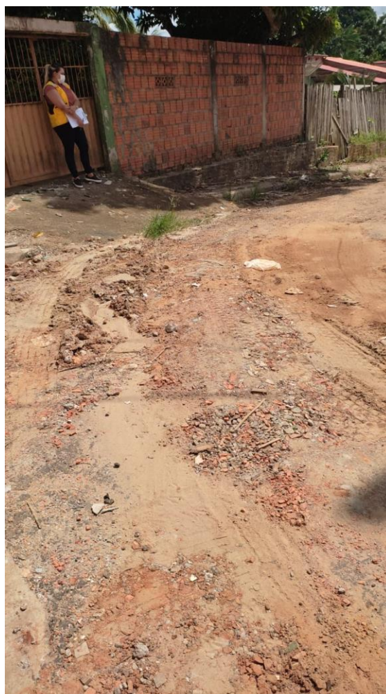
Figura 1 – Rua necessita da manutenção em sua pavimentação.
