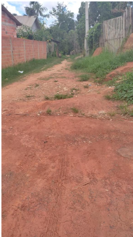
Figura 1 – Rua necessita da manutenção em sua pavimentação.
