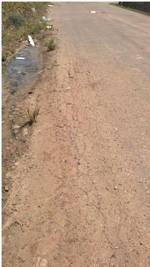
Figura 1 – Rua necessita da manutenção em sua pavimentação.
