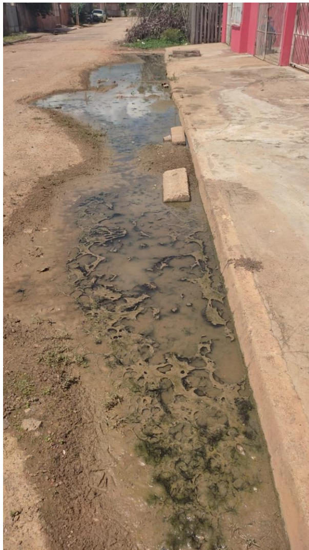
Figura 1 – Pavimentação com buracos e esgoto cheio(entupido).
