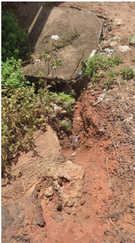
Figura 1 – Pavimentação com buracos e esgoto cheio(entupido).
