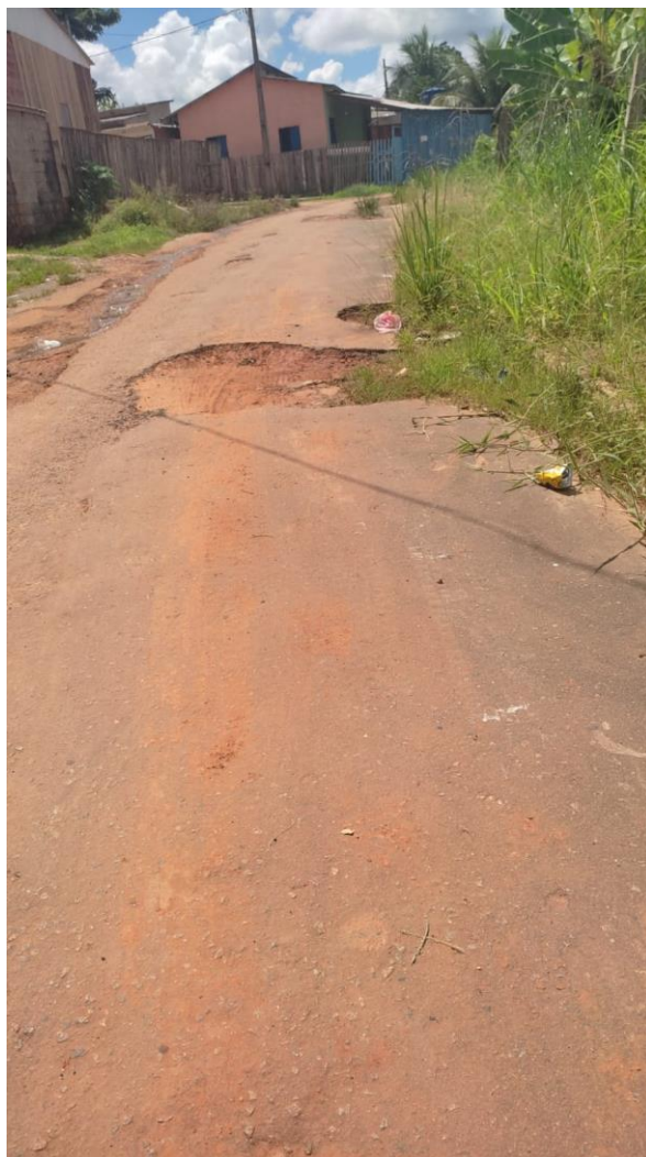
Figura 1 – Rua necessita da manutenção em sua pavimentação.
