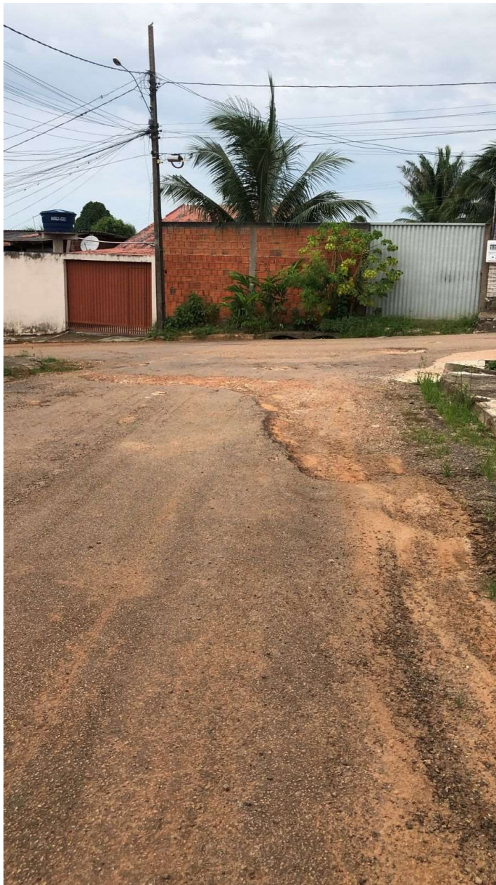
Figura 2 – Buraco de grande extensão na via.
