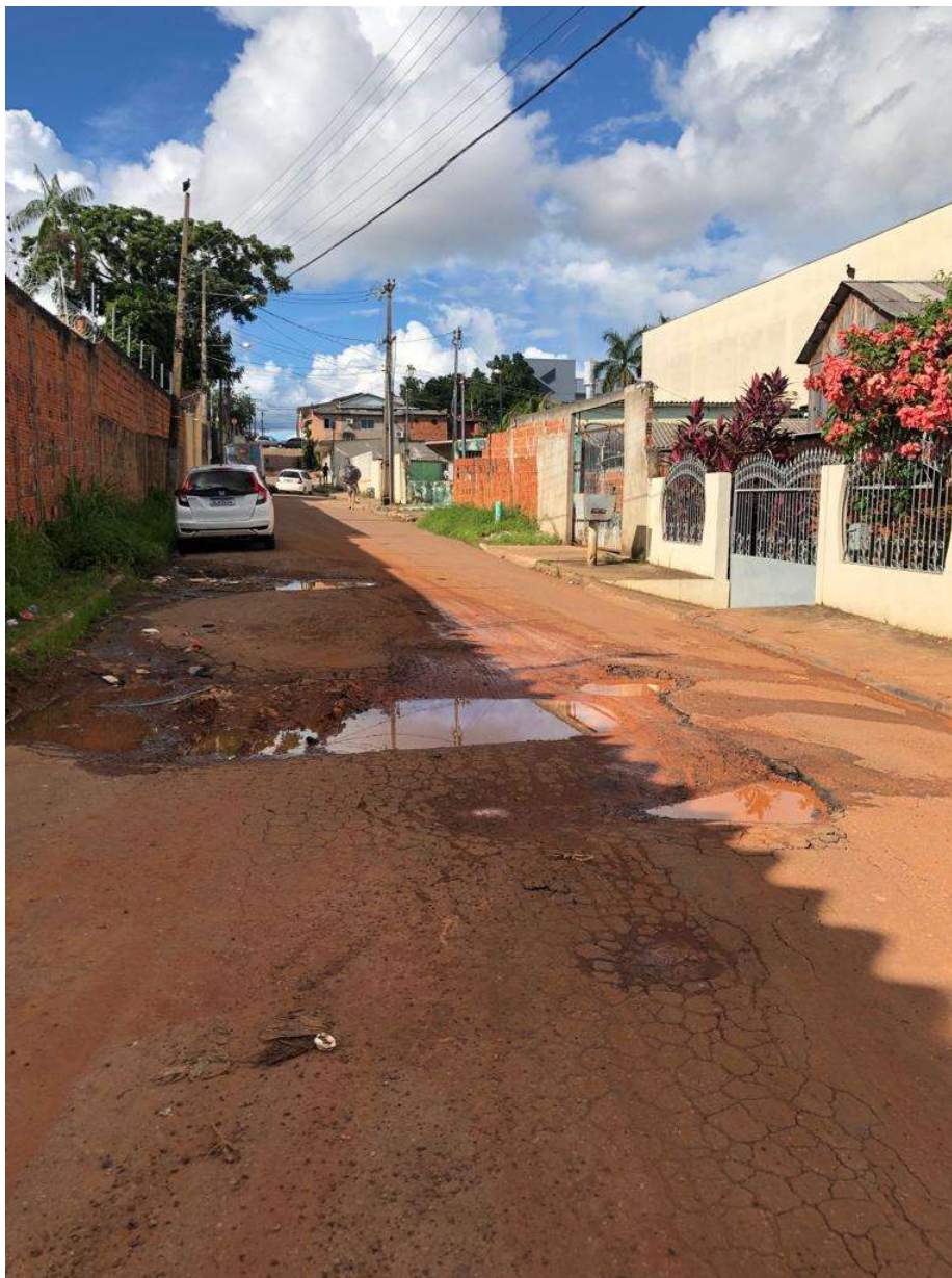
Figura 3 – Buracos de grande extensão.
