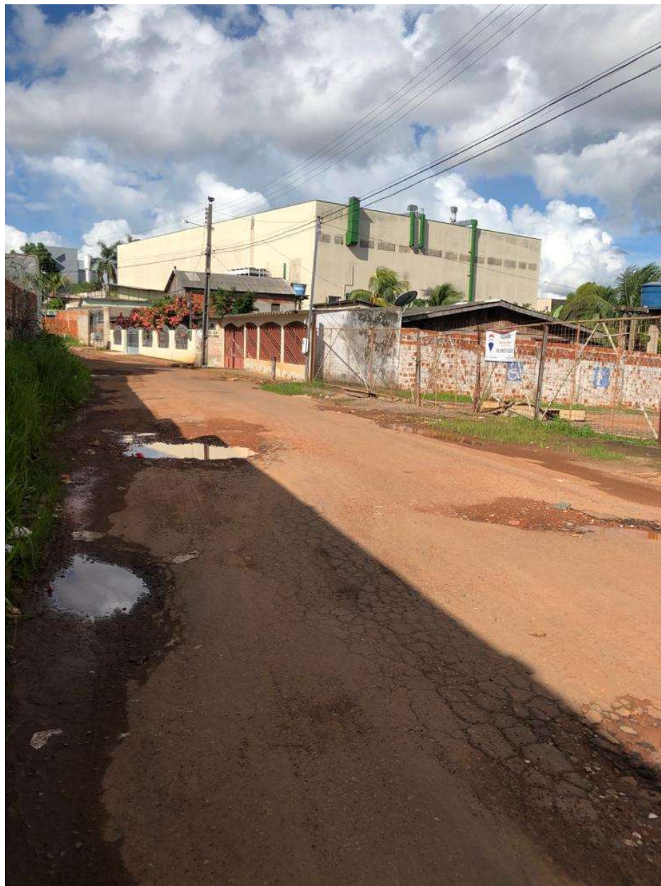
Figura 2 – Buracos que prejudicam a trafegabilidade da via.
