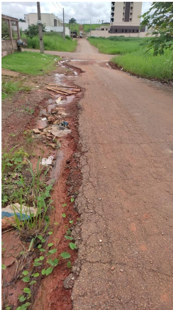
Figura 1 – Depreciação na massa asfáltica.
