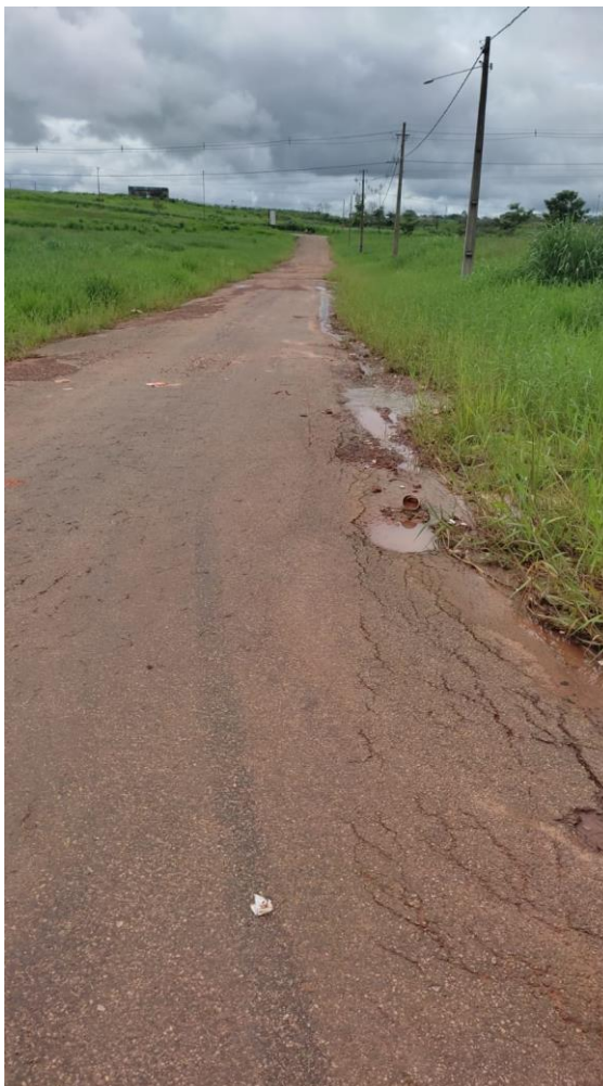
Figura 1 – Depreciação na massa asfáltica.
